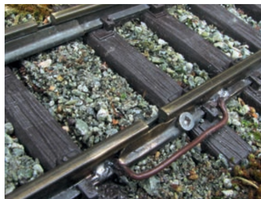
Bei gewollten Dehnungsfugen wird nur ein Profil verschraubt. Den Stromfluss sichert eine verlötete elastische Drahtbrücke aus Litzen (Querschnitt 1,5 mm).
